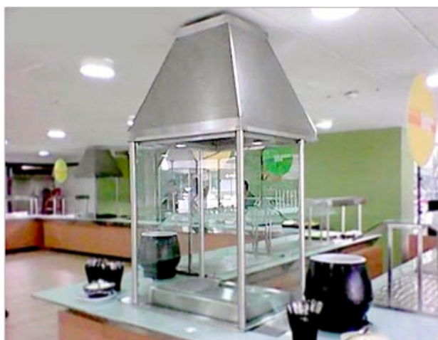
Coifa instalada no refeitório da volkswagen
